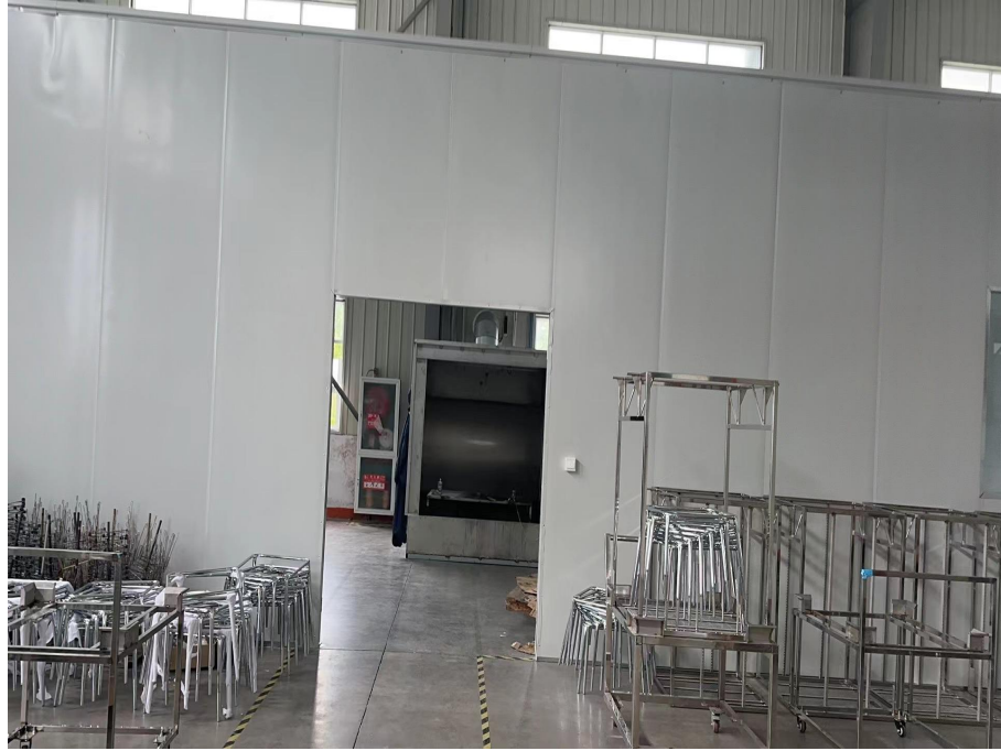
涂装废气收集装置
