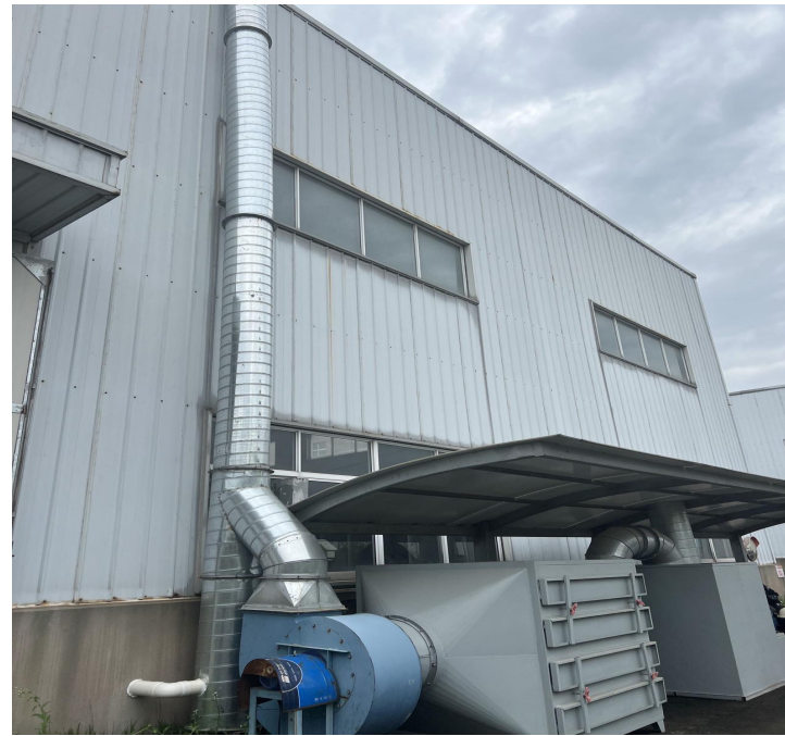
涂装废气处理装置及排气筒
